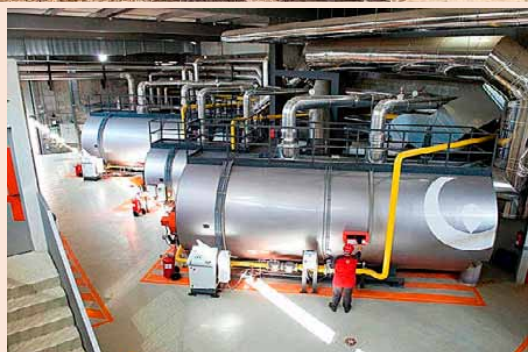
Sala de calderas del Hospital Universitario La Paz en Madrid.
