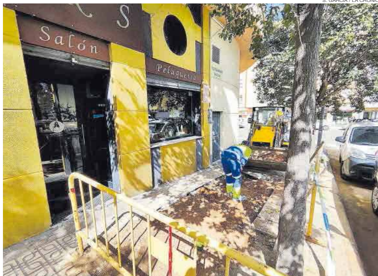
Los operarios de Aqualia trabajan en un nuevo reventón frente a la peluquería París.
